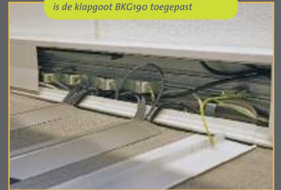
In de meer bekabelingsintensieve ruimtes is de klappoot BKG190 toegepast
