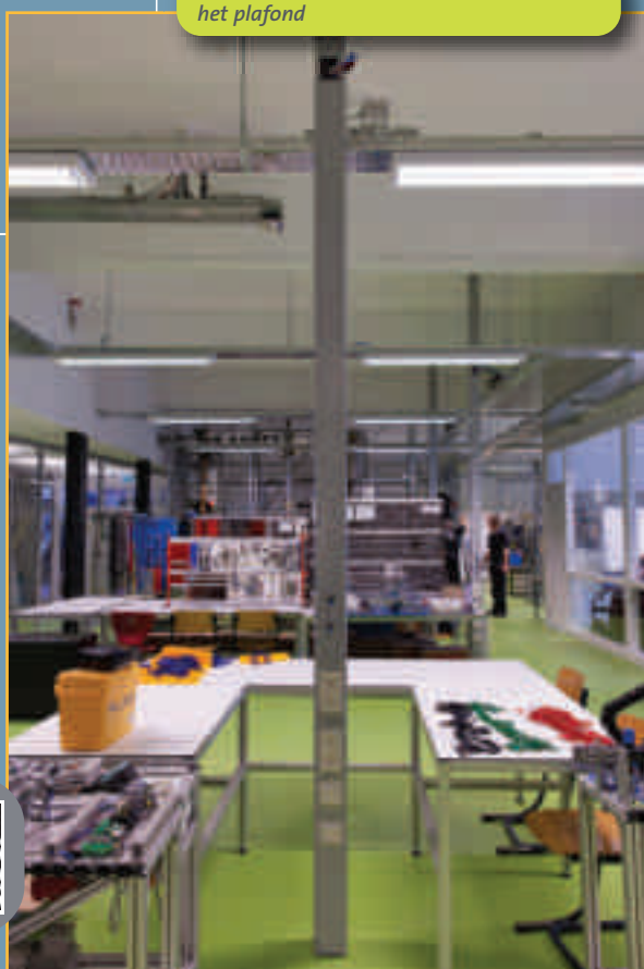
BP220 gevoed vanuit de kabelgoot aan het plafond
