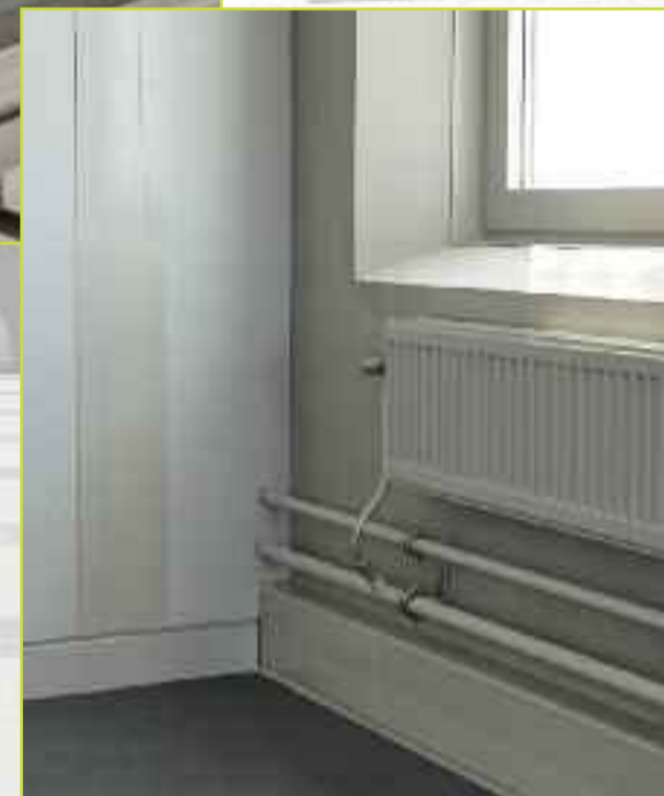
Kleurstelling van de klapgoot geheel in lijn met de verwarmingsbuizen.
